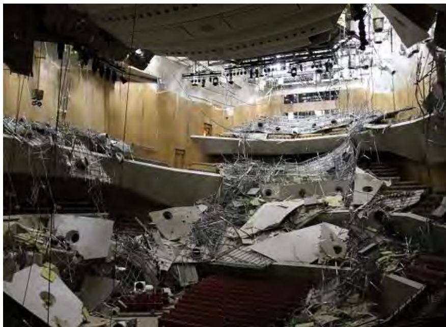
音楽ホールにおける天井の脱落
