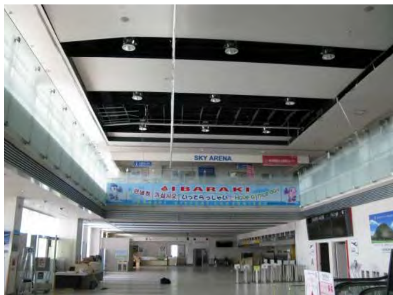
旅客施設における天井の脱落
