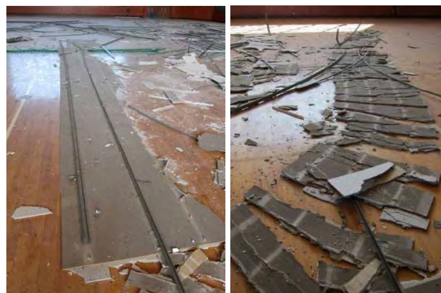
脱落した天井部材
